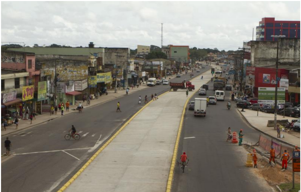
Figura 4 - Registro da Avenida Augusto Montenegro após implantação do BRT e a constatação de que a arborização não é uma prioridade.
